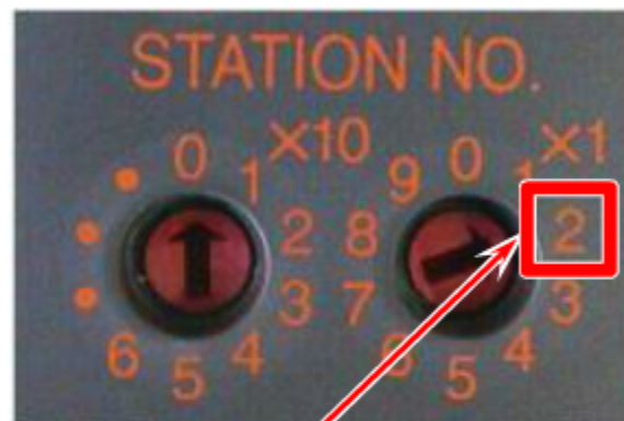
Станция № 2: станция удаленного ввода/вывода (AJ65BTC1-32T, 32 точек, транзисторный выход)
