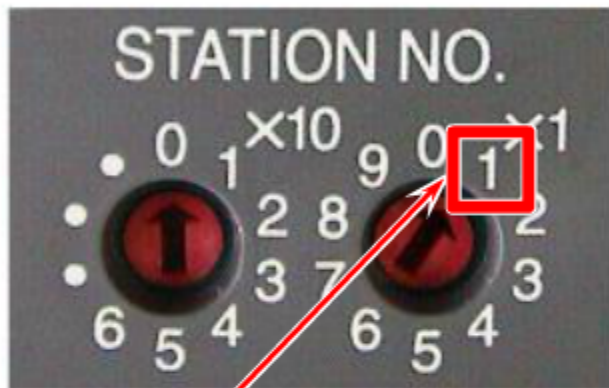
สถานี #1: สถานีรีโมท I/O (AJ65BTB2-16D อินพุตไฟฟ้ากระแสตรง 16 พอยท์)
