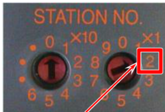
Nº da estação 2: Estação de I/O remota (AJ65BTC1-32T, 32 pontos, saída à transistor)
