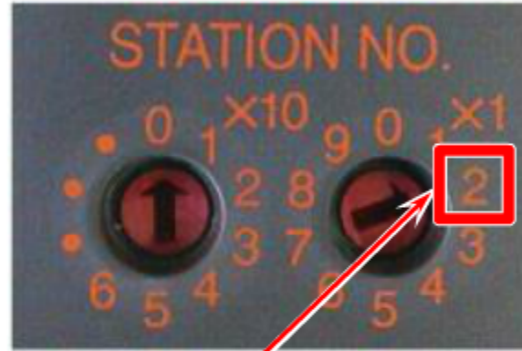
İstasyon no. 2: Uzak I/O istasyonu (AJ65BTC1-32T, 32 noktalı, transistör çıkışı)
